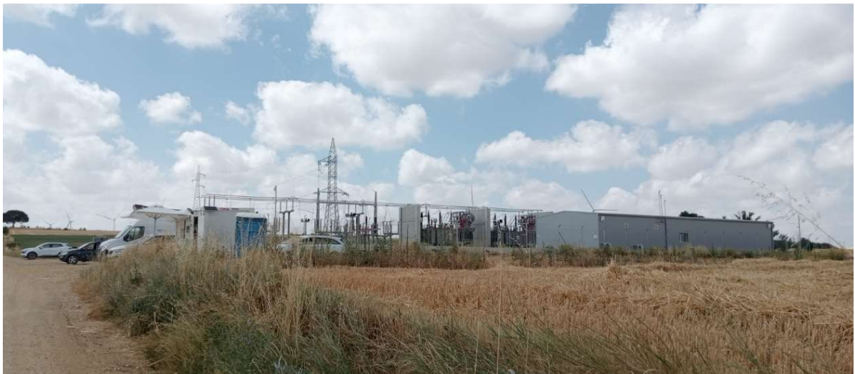
Subestación "La Higuera" donde está prevista la evacuación de la energía generada por el "Proyecto Híbrido Alcornoque". Se aprecian en la imagen las líneas eléctricas de alta tensión y, al fondo, los aerogeneradores del parque eólico "Villaumbrales".
